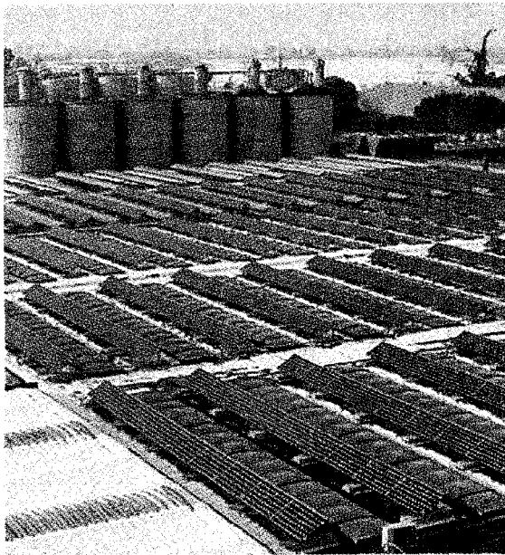
Il tetto degli stabilimenti della Piberplast di Voghera ospita il più grande impianto a pannelli solari della provincia
